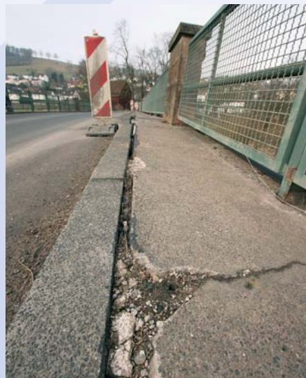
Das Geländer und der Oberbau müssen dringend saniert werden
